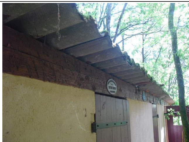
035 : Plaques ondulées Gîte/Ecuries Gîte/Ecuries (niv:0)
