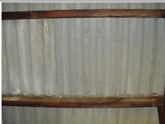
029 : Plaques ondulées Annexes/Garage Annexes/Garage (niv:0)
