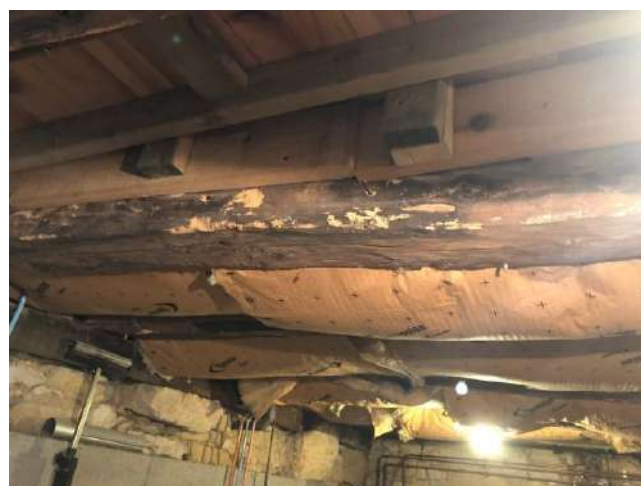
INS004 Maison - Logement / Cave - local technique PH2 : Poutre maitresse Insectes à Larves Xylophages (ILX)
