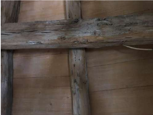
INS007 Maison - Logement / Escalier RDC v 1er 2 PH10 : Poutre maitresse Insectes à Larves Xylophages (ILX)
