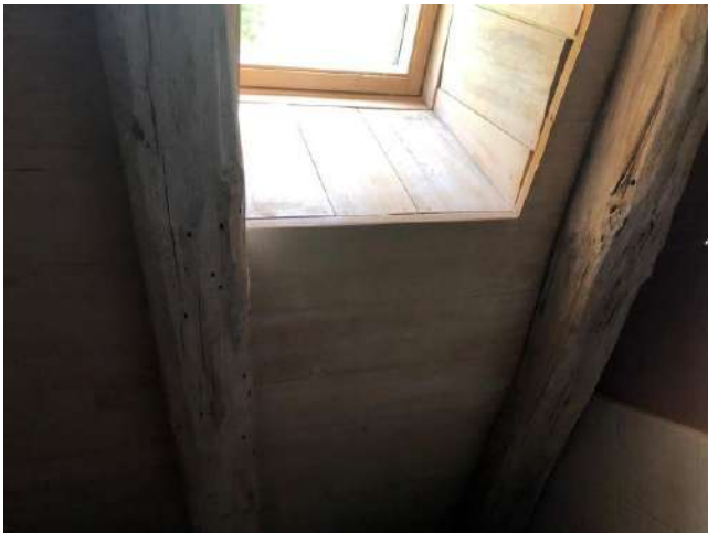
INS009 Maison - Logement / Salle de bain 2 PH9 : Poutre maitresse Insectes à Larves Xylophages (ILX)
