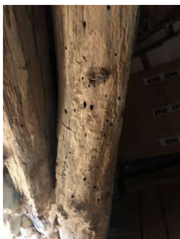
INS003 Maison - Logement / Grenier PH6 : Poutre maitresse Insectes à Larves Xylophages (ILX)
