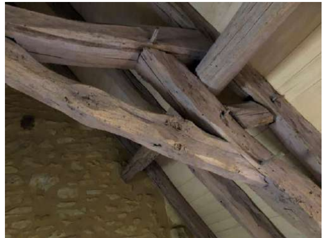
INS010 Maison - Logement / Chambre 6 PH12 : Poutre maitresse Insectes à Larves Xylophages (ILX)
