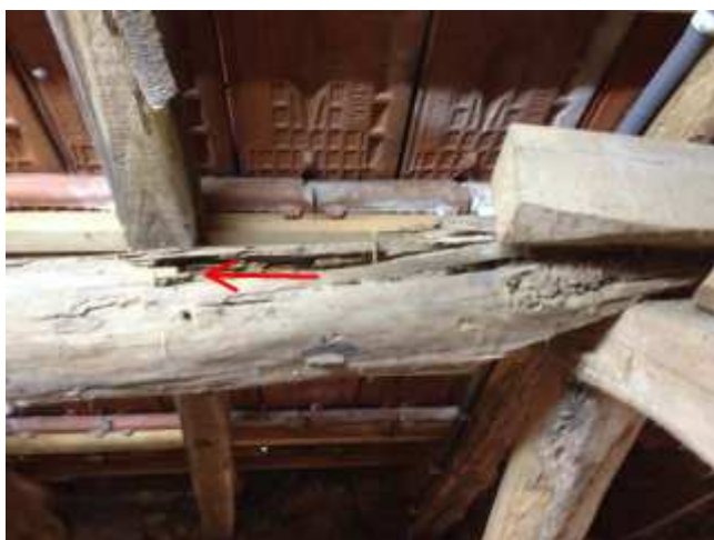
INS003 Maison - Atelier/Grenier PHMP2 : Poutres maitresses Termites souterrains
