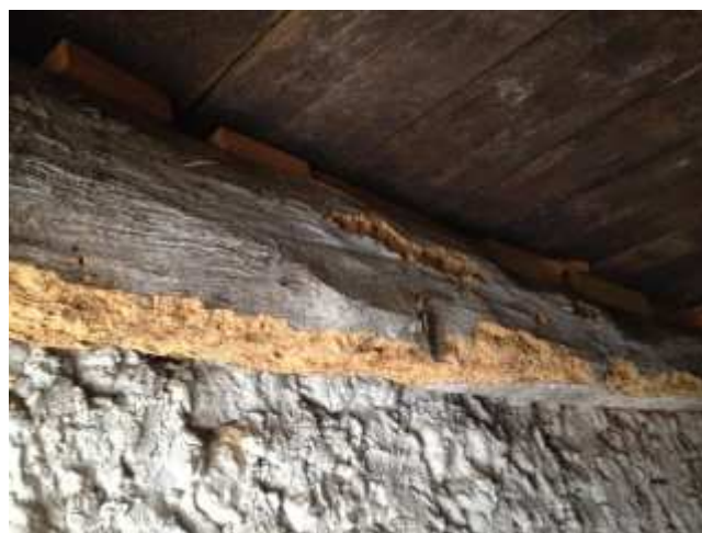
INS004 Maison - Dépendances/Débarras PHMP3 : Poutres maitresses Insectes à Larves Xylophages (ILX)
