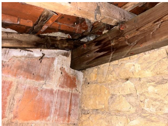
INS002 Maison - Logement / Combles PH:IMG_3862 Poutre maîtresse Champignons (présence d'indice)
