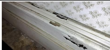
Photo n° PhTer001 Localisation : Rez de chaussée - Dégagement Ouvrage : Plinthes - Bois et Peinture Parasite : Termites souterrains Indices : altérations dans le bois
