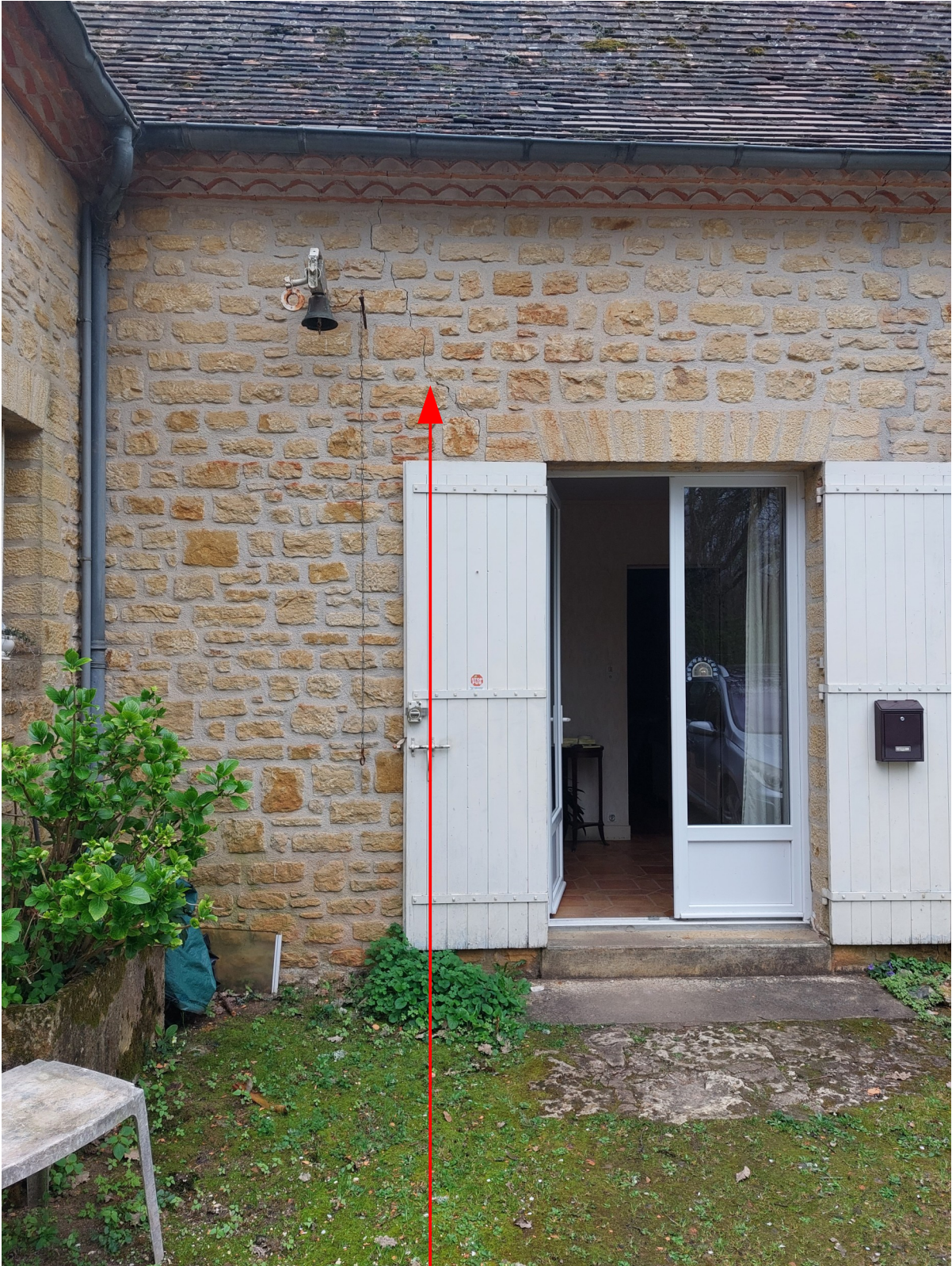
Fissure à gauche de la porte
