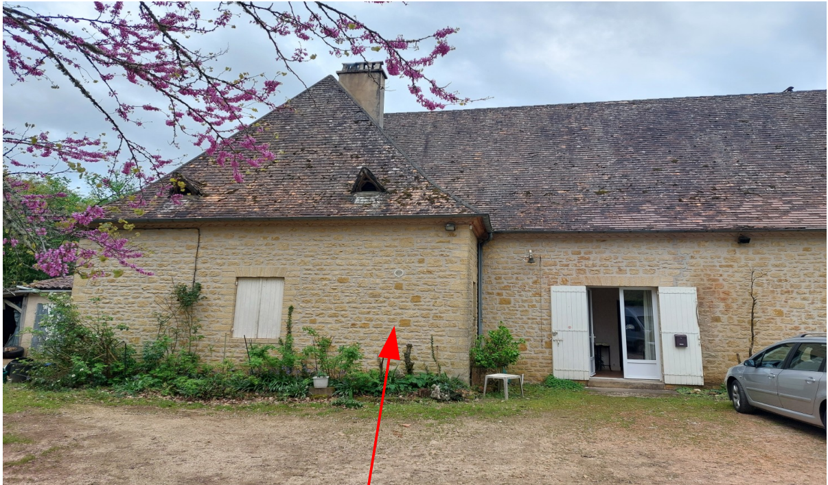
Aile gauche non affectée par des désordres
