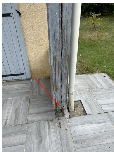
INS002 Maison - Logement / Abords PH:IMG_6770 Poteau champignons (présence d'indice)
