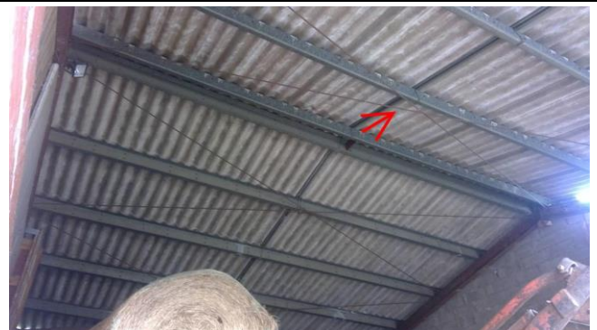
004 : amiante ciment Annexes/Atelier/Garage Annexes/Atelier/Garage (niv:0)
