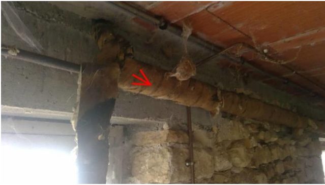
001 : Calorifugeages Habitation principale/Garage/Chaufferie Habitation principale/Garage/Chaufferie (niv:-1) - PRE:P001
