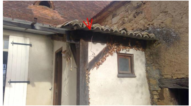
002 : amiante ciment Habitation principale/Remise Habitation principale/Remise (niv:0)
