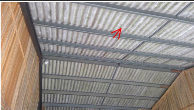
003 : amiante ciment Annexes/Hangar Annexes/Hangar (niv:0)
