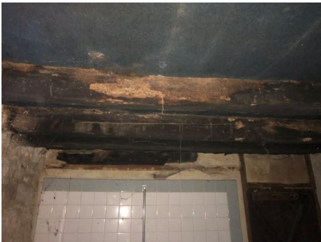
INS004 Maison - Logement / Salle de bain PH2 : Poutre maitresse Insectes à Larves Xylophages (ILX)
