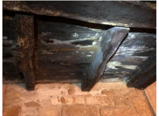
INS003 Maison - Logement / Chambre - SDE PH3 : Plancher supérieur Champignons
