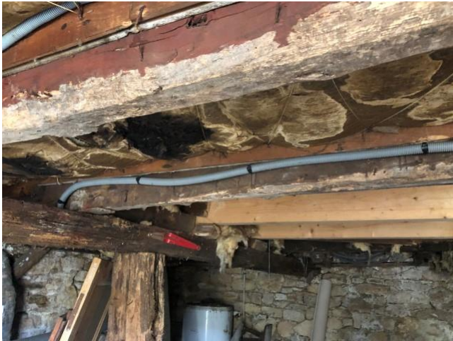
INS002 Maison - Logement / Cave PH4 : Poutre maitresse Insectes à Larves Xylophages (ILX)
