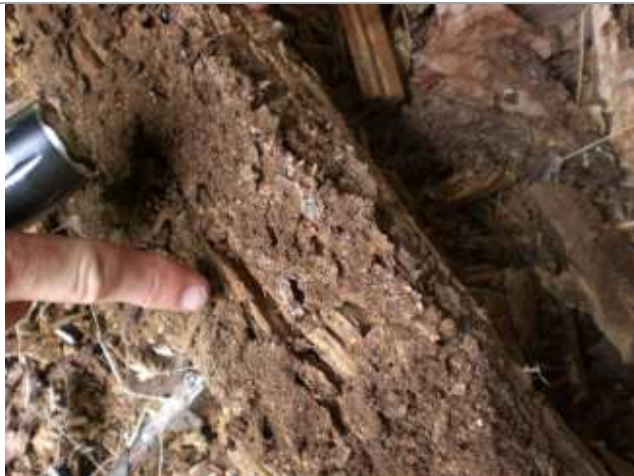
Présences de termites sur bois au sol
