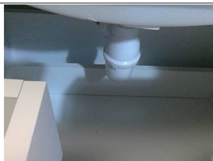
Photo n° PhA007 Localisation : 1er étage - Salle d'eau - wc Ouvrage : Conduits de fluides (air, eau, autres fluides) Partie d'ouvrage : Conduits Description : Conduits
