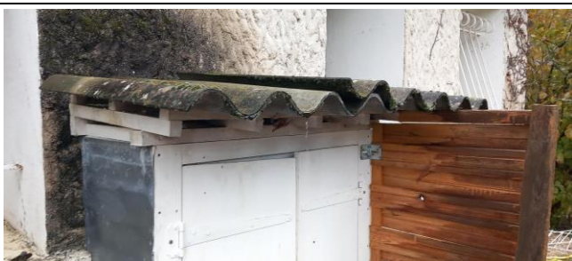
002 : Plaques ondulées en couverture Local technique piscine Local technique piscine (niv:0)
