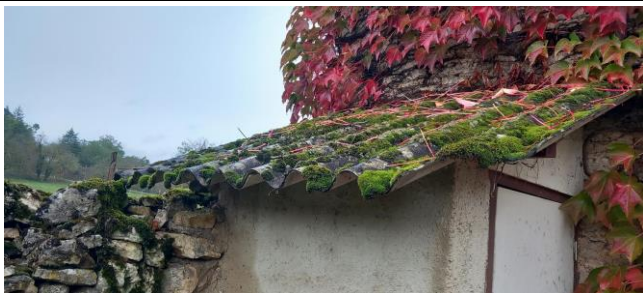
001 : Plaques ondulées en couverture Débarras Débarras (niv:0)
