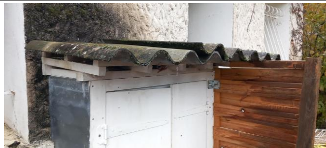
001 : Plaques ondulées en couverture Débarras Débarras (niv:0)
