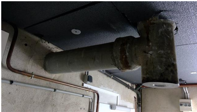
001 : amiante ciment Garage Garage (niv:-1)
