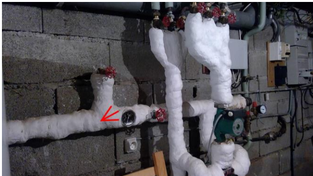
001 : Calorifugeages Chaufferie - PRE:GD001
