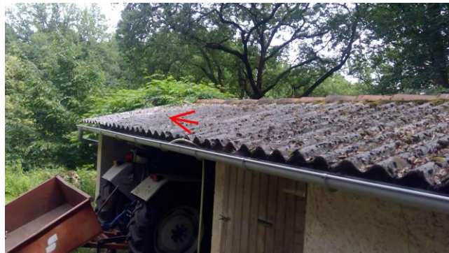
002 : amiante ciment Annexes/Garage
