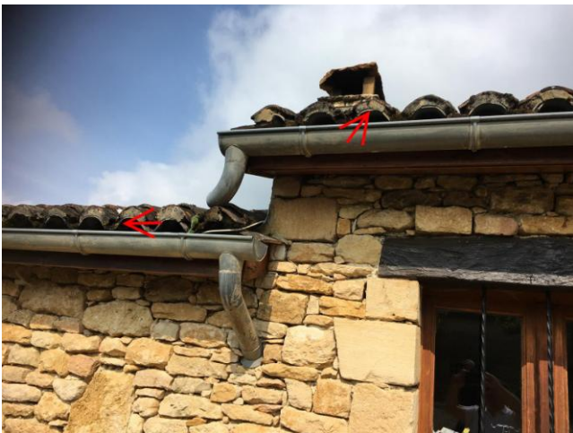
001 : Plaques ondulées en couverture Habitation principale/Entrée - PRE:001
